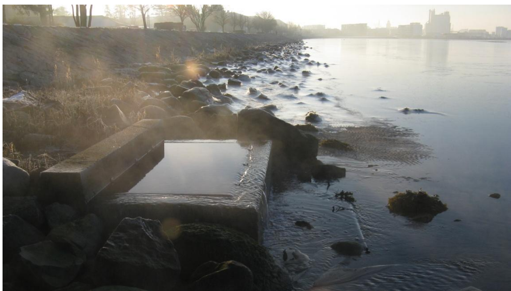
Figur 23: Overløbsbygværk i Nykøbing. Her løber der i perioder med nedbør opsødet spildevand fra bl.a. hospitalet ud i Guldborgsund.
