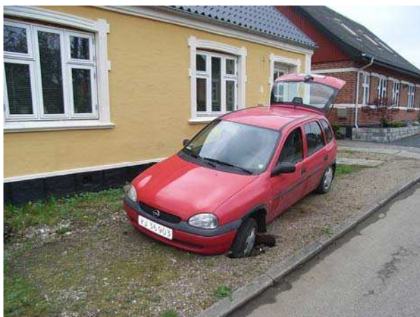
Sammenstyrtet kloak, Grønnegade 4, Hundslund
