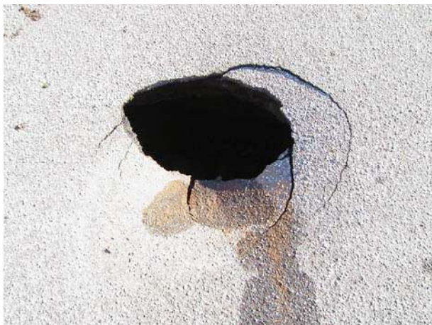
Hul i asfalten
