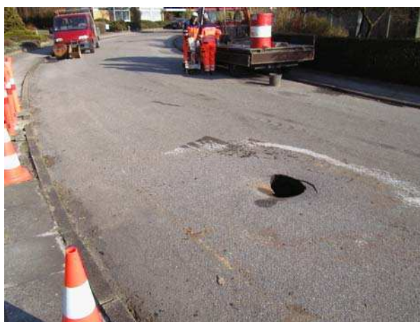
- ca. 1 m 3 jord/sand var spulet væk under asfalten p.g.a. utætte ledninger
